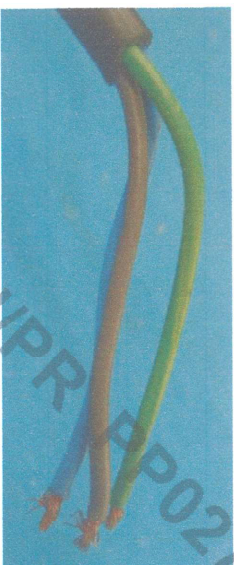
Foto 8 - Fiação externa da amostra.
